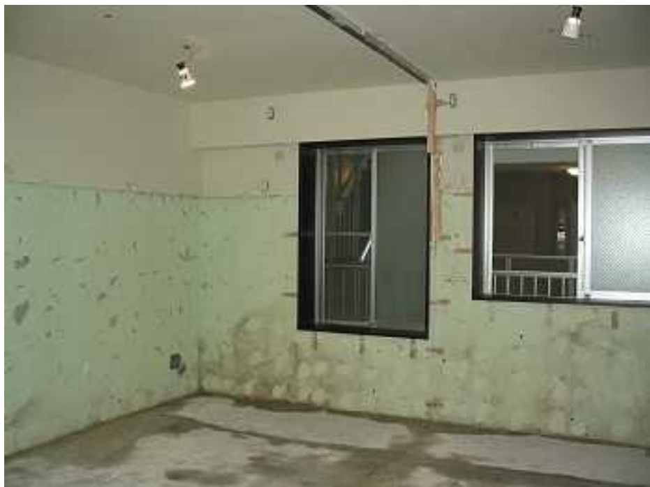
リノベーション後に配管からの水漏れが発覚、全面解体となった事例 （さくら事務所ホームインスペクション事例より）
